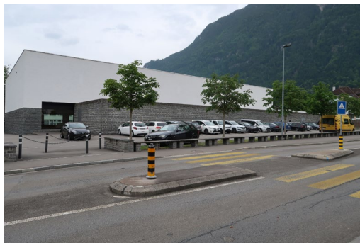
Abbildung 8: Beispiel einer mangelhaften Querungshilfe aufgrund fehlendem Randabschluss (Aufnahme in Altdorf)
