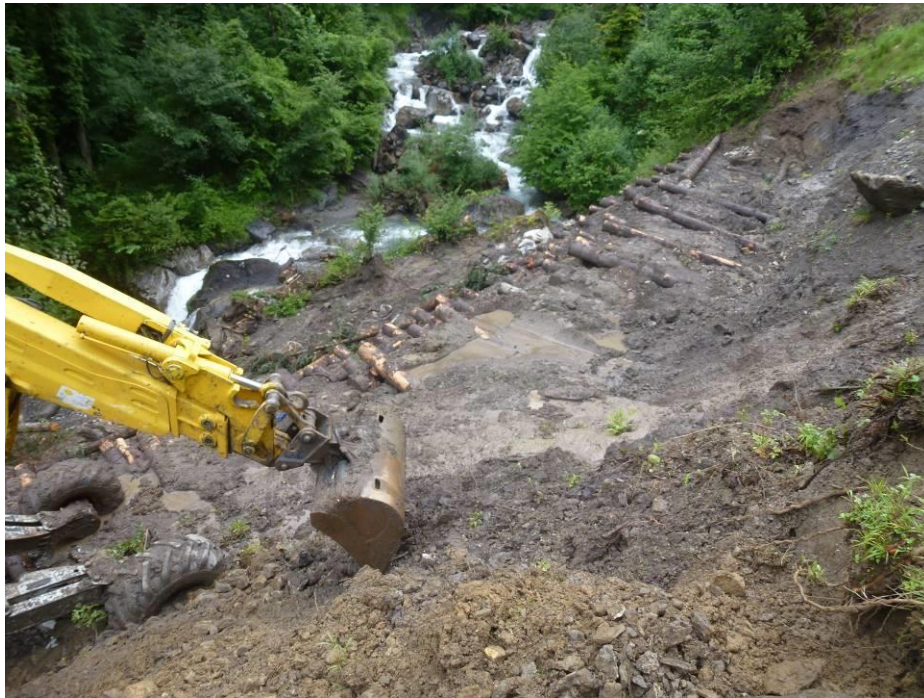
Foto 19: Böschungsnachbruch aus verflüssigtem Material (oeko-b, 20.06.2016).
