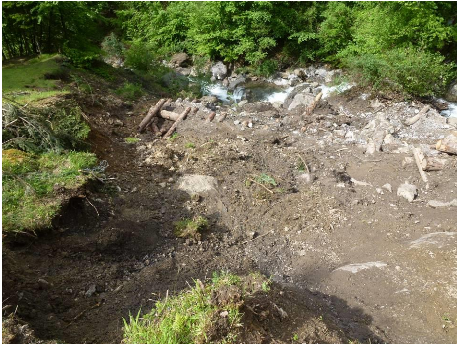
Foto 13: Böschungsnachbruch in jenem Bereich, welcher die stärksten Vernässungen aufwies (oeko-b, 17.05.2016).
