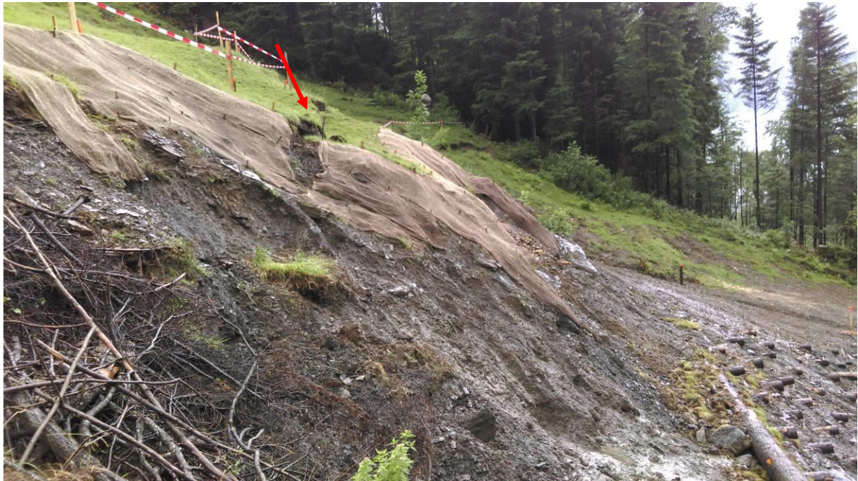
Foto 25: Kurz vor Abschluss der Arbeiten brach oberhalb des Holzkastens eine Scholle an (roter Pfeil) (oeko-b, 14.07.2016).
