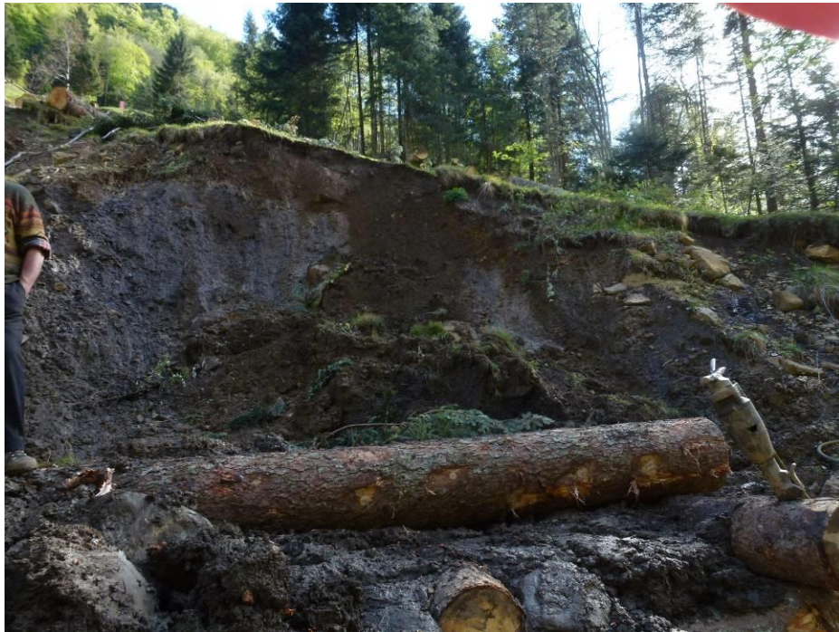
Foto 5: Kleinerer Böschungsnachbruch im Bereich des Aushubes (oeko-b, 28.04.2016).
