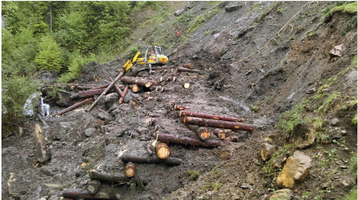
Foto 10: Verbauarbeiten unter anspruchsvollen Witterungsbedingungen, am linken Bildrand sind dem Holzkasten vorgelagerte Blöcke erkennbar (oeko-b, 12.05.2016).
