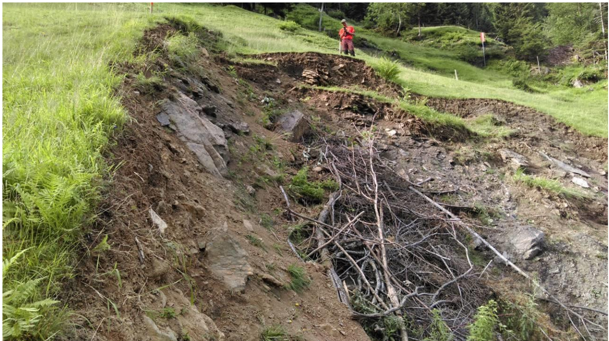
Foto 24: Von Hand gebrochene Kanten in den Böschungen oberhalb des Holzkastens (oeko-b, 08.07.2016).
