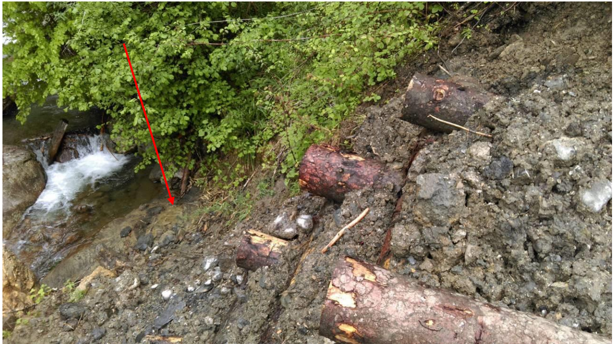
Foto 15: Oberes Ende des Holzkastens. In diesem Bereich konnte beim Aushub auf Fels gestossen werden (roter Pfeil), so dass es möglich war, das Holz mit Ankereisen zu verankern (oeko-b, 30.05.2016).
