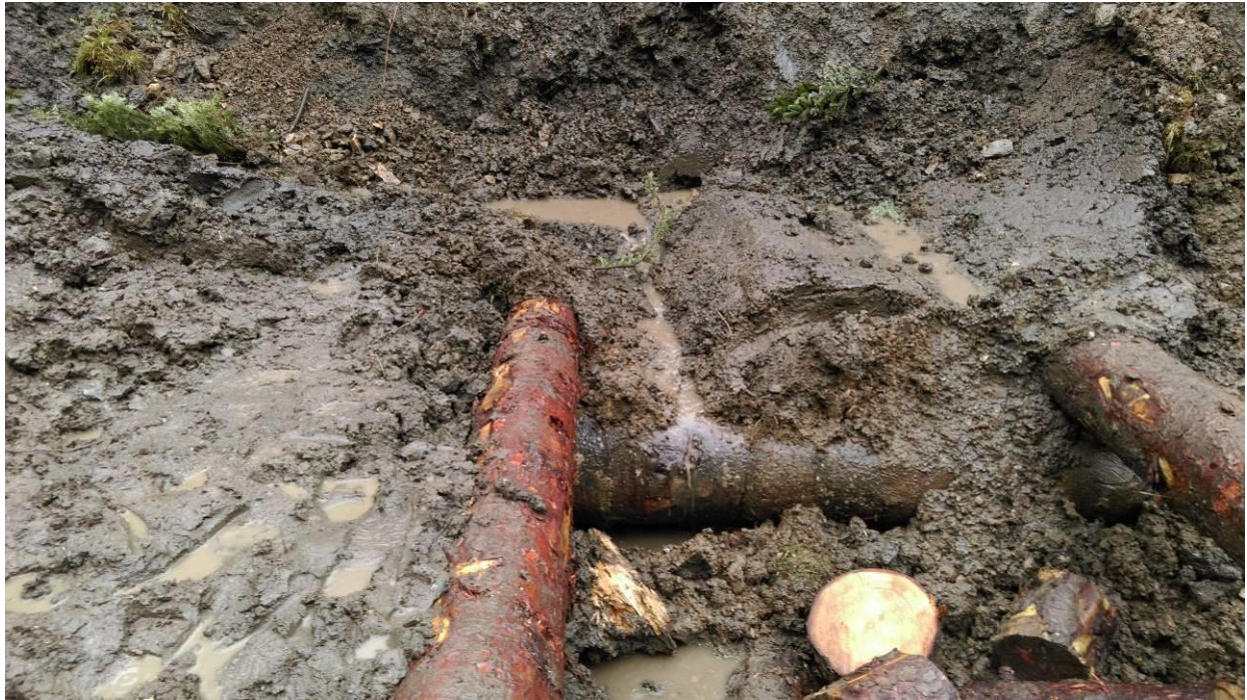
Foto 11: Wasseraustritte aufgrund von mehrtägigen Niederschlägen (oeke-b, 12.05.2016).
