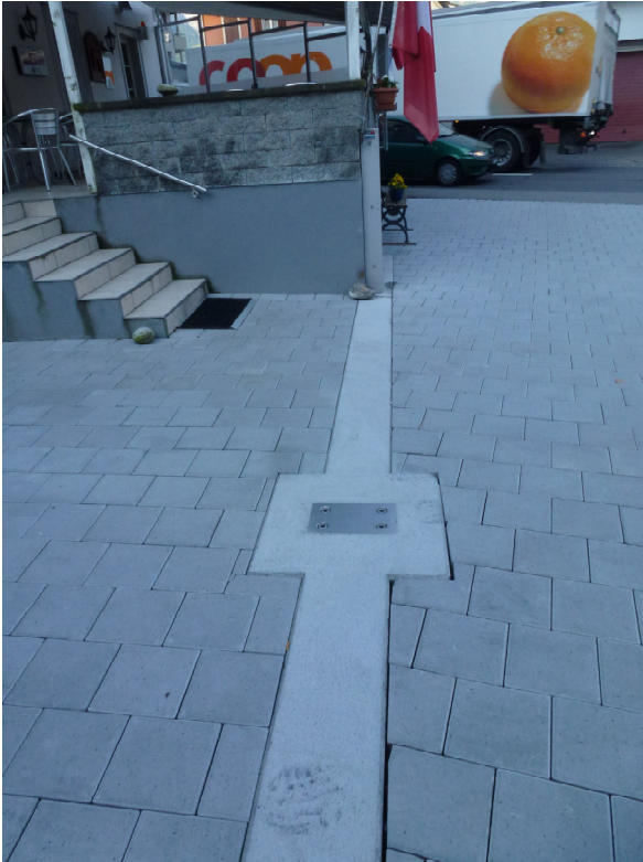
Abb. 3: Dammbalkenverschluss bei Rest. Laterne mit Anschluss bei Terrasse 18.05.2018
