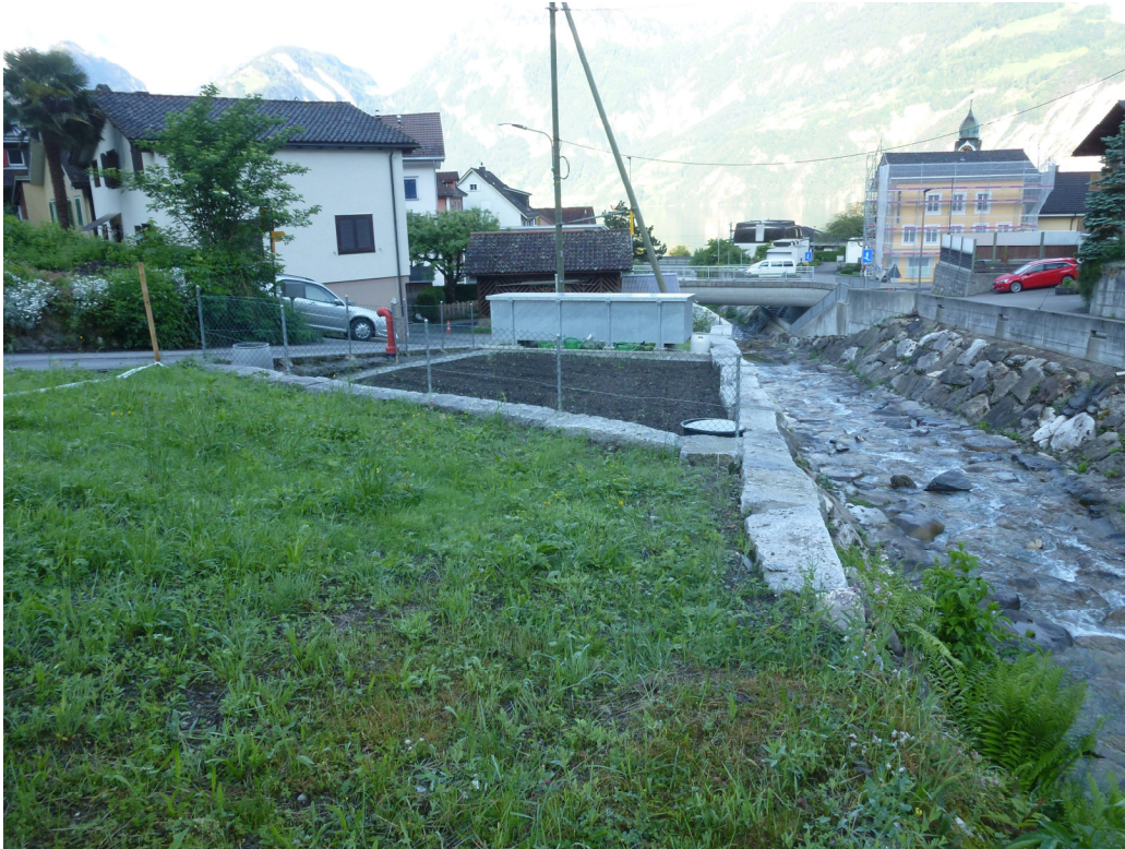
Abb. 9: Erhöhung mit Quaderförmigen Blocksteinen entlang Riemenstaldnerbach und Dammbalken-depot für Dammbalkenverschluss bei Rest. Laterne 18.05.2020
