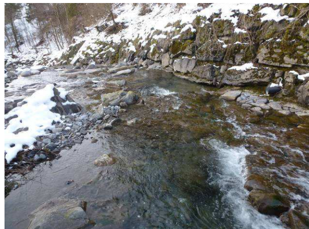
Abbildung 17: Bereich der Wasserleitung --> Abschnitt mit mehreren Auskolkungen und Unterspülungen, insbesondere am rechten Ufer und am unteren Ende der bestehenden Pflästerung.
